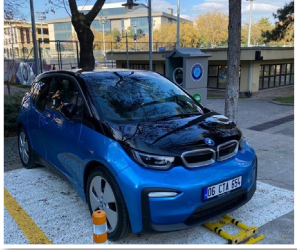
Elektrikli Araç Şarj İstasyonları
