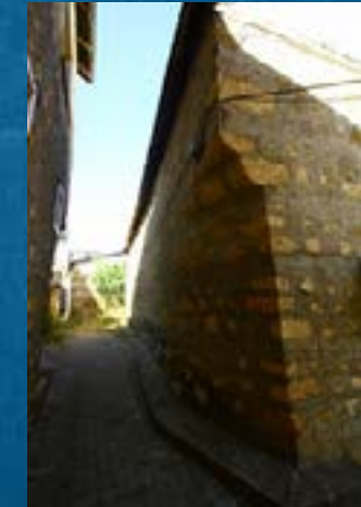
Görsel 16. 104 ada 6-7 parseldeki evin cephesinde çal köşe
