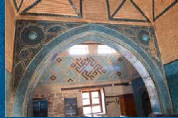
Fotoğraf 28. Sahip Ata Türbesi doğu cephesi sonradan açılan pencere (Erdemir, 2018)
