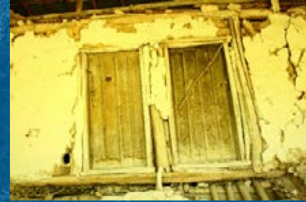
Görsel 20. 110 ada 5 parseldeki evde bir iç duvar
