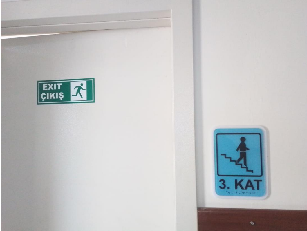
Laboratuvar Binası Yangın Çıkışı 3. kat
